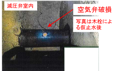
R8-6(空気弁破損)
