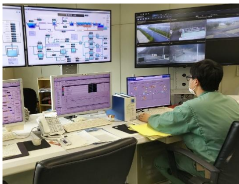
中央監視制御装置による監視
