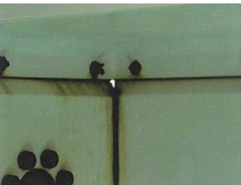
接合部のすき間
