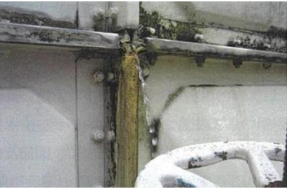
接合部から漏水
