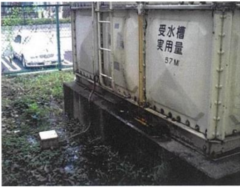
本体の漏水によるたまり水
