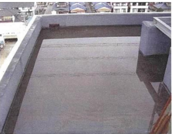
排水不良によるたまり水
