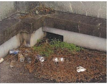
排水口のつまり
