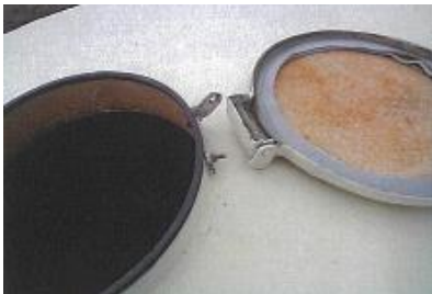
マンホール取り付け部破損
