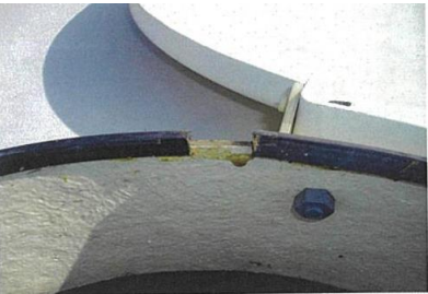
パッキンの劣化
