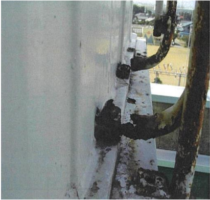
梯子腐食破損(下部)
