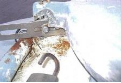
鍵取り付け部破損
