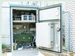
▲水質監視モニター装置
