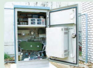
▲水質監視モニター装置
