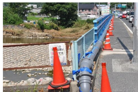
【豪雨災害復旧(上深川町・鳥声橋)】
