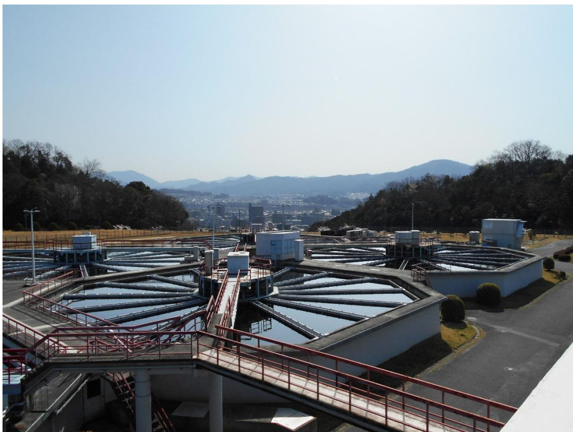
—緑井浄水場 高速凝集沈でん池—
