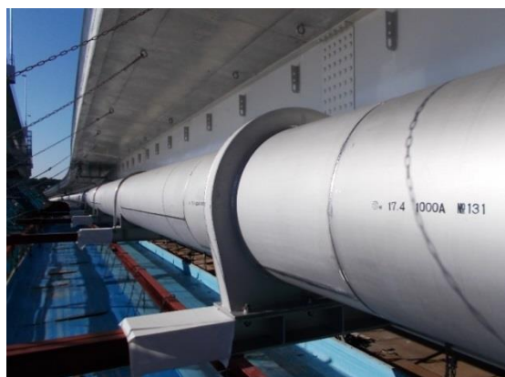
図9 江波大橋に添架した広島南配水幹線 (口径 1000 mm ステンレス鋼管)
