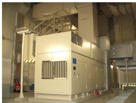
図10 浄水場に整備した自家発電設備 (ガスタービン発電機)
