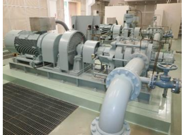
▲ 高効率電動機採用のポンプ設備
